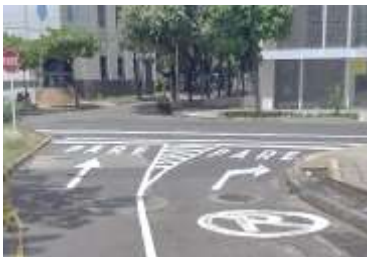
Señalización horizontal Calle 51 carrera 10 Mano rotaria, sector comercial
